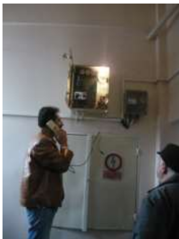
Mentenanță sistem de alarmare
