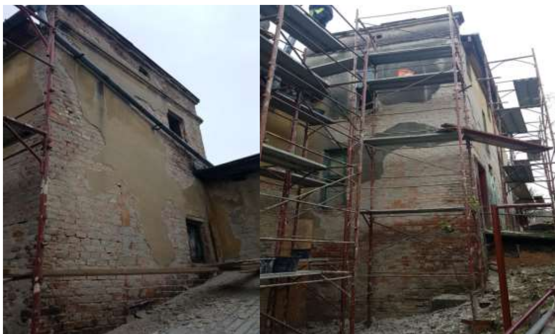
Ceahlau nr.10 înainte de reparații
