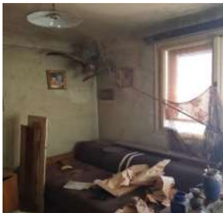
Castanilor nr.1 Înainte de reparații
